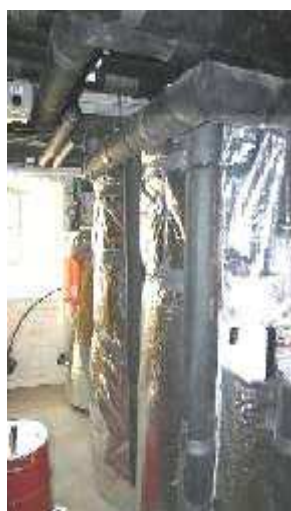
Izolacja zbiorników energii słonecznej
